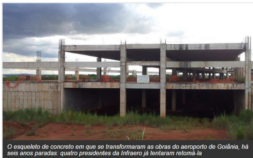
Figura 1. Obras paralisadas no Aeroporto de Goiânia.
